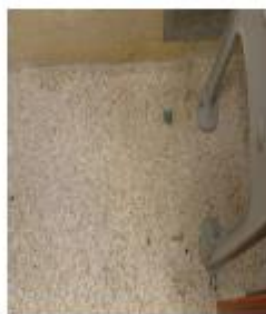
Figura2. Desprendimiento de rampiús que sujetan la silla
